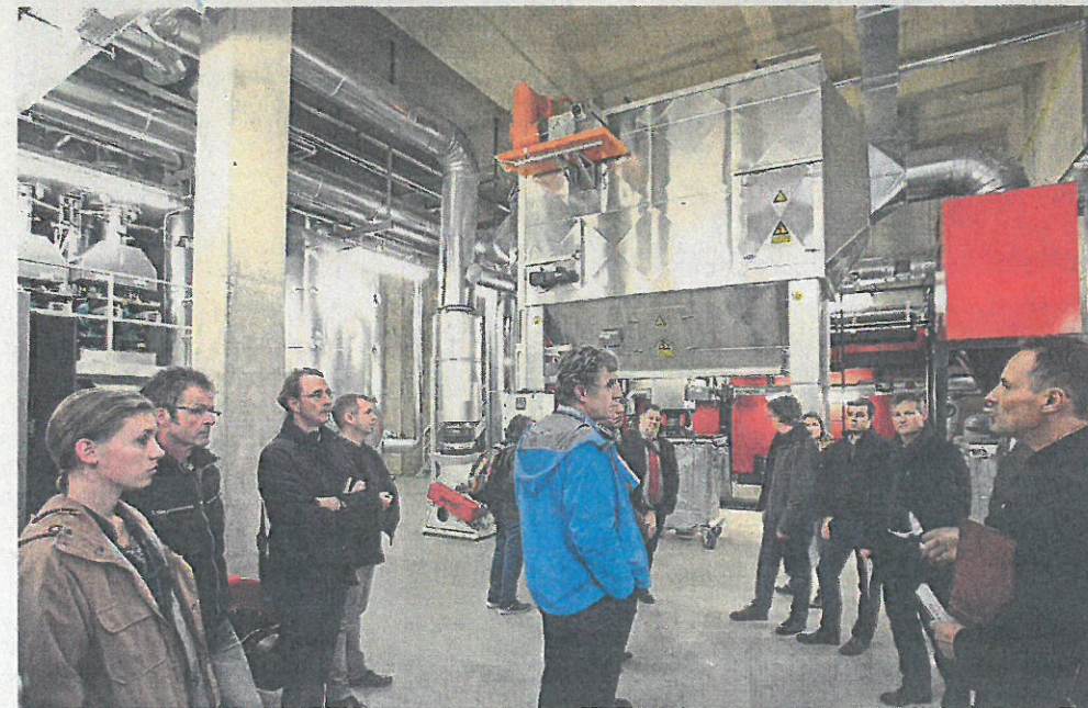
Im Hang verschwunden ist das Hackschnitzelheizwerk, das alle Einrichtungen des Schulzentrums mit Wärme versorgt.
